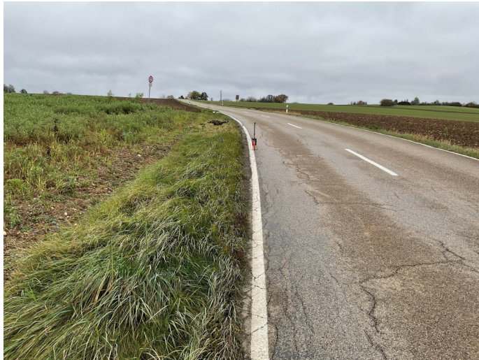
Aktueller Straßenzustand, © Gemeinde Vaterstetten
