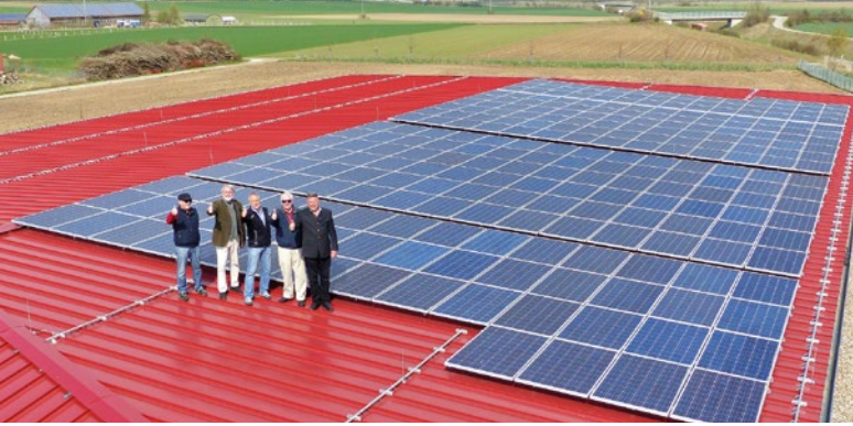
Mit Photovoltaik-Anlagen wie dieser auf der Sporthalle Zorneding erzeugt die 3E schon seit einigen Jahren erneuerbaren Strom in Bürgerhand.
